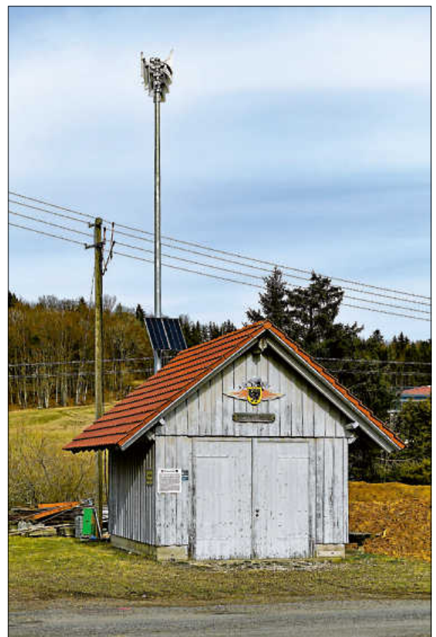
Hinter dem Spritzenhäusle auf dem Geyerbad ist die Sirene an einem eigens aufgestellten Mast montiert. Die nötige Energie liefert eine Solar-Paneele.
